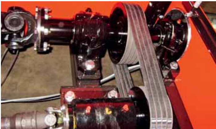
Einfaches Keilriemenvorgelege für den Antrieb der zweistufigen Hydraulikpumpe.
